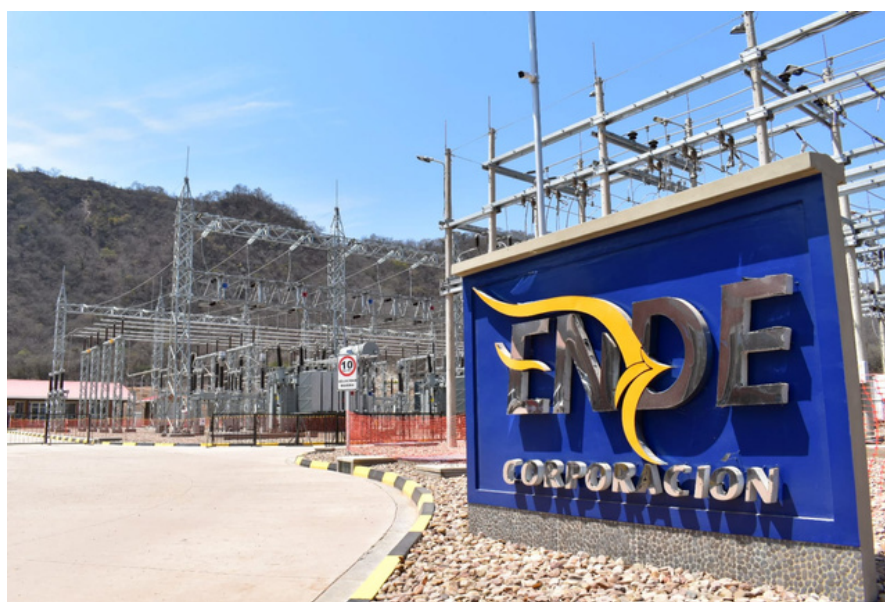
Subestación Camiri, parte del Proyecto de Interconexión Camiri al SIN
